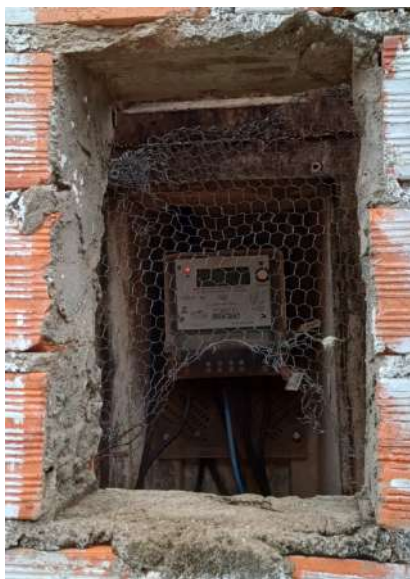
FOTO 26: Medidora de energia elétrica.
