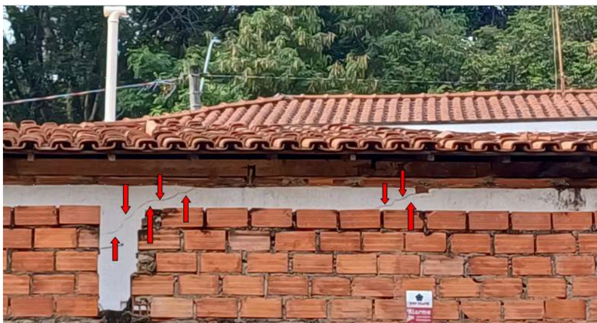
FOTO 29: Fissuras na parede lateral direita do Imóvel Avaliando.
