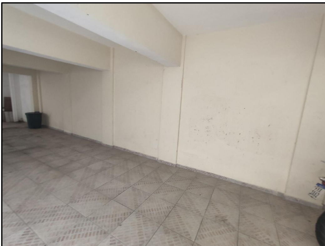
Ilustração 24: Pavimento térreo – Estado de conservação da garagem de veículos
