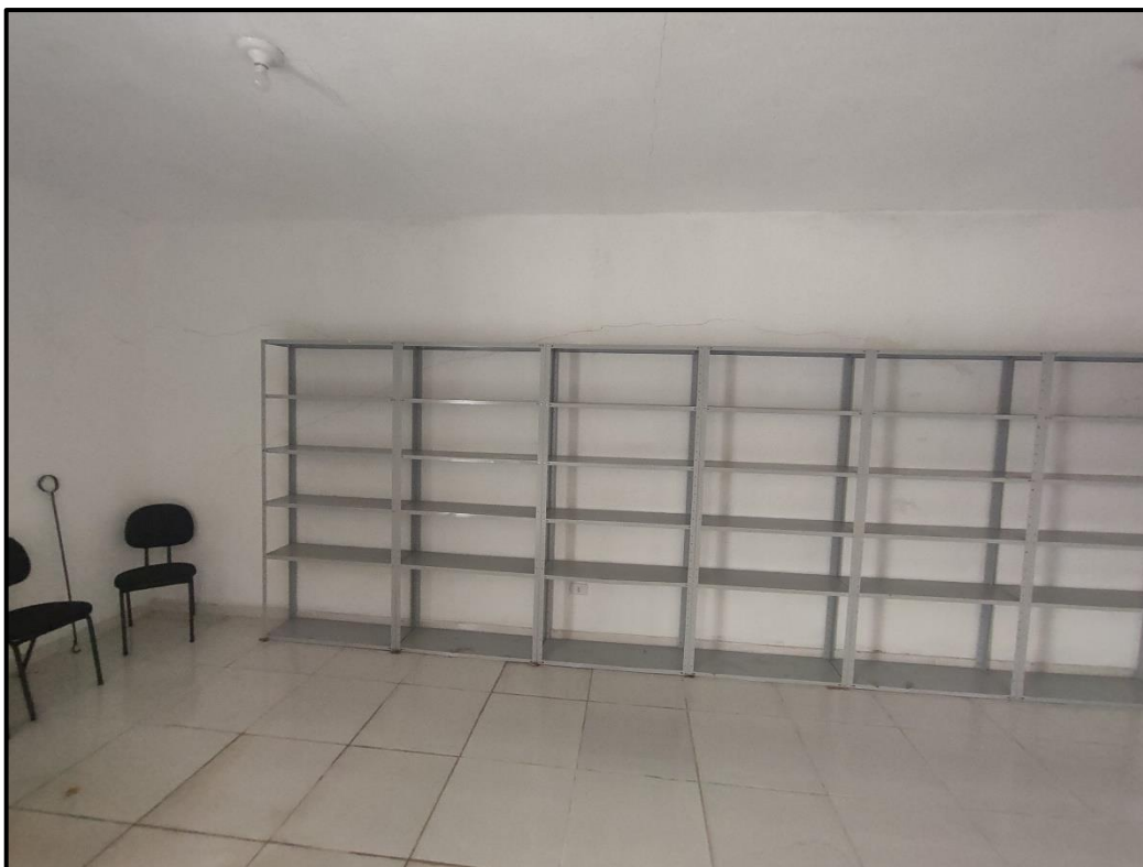
Ilustração 40: 1º pavimento (1º andar) – Estado de conservação do local copa
