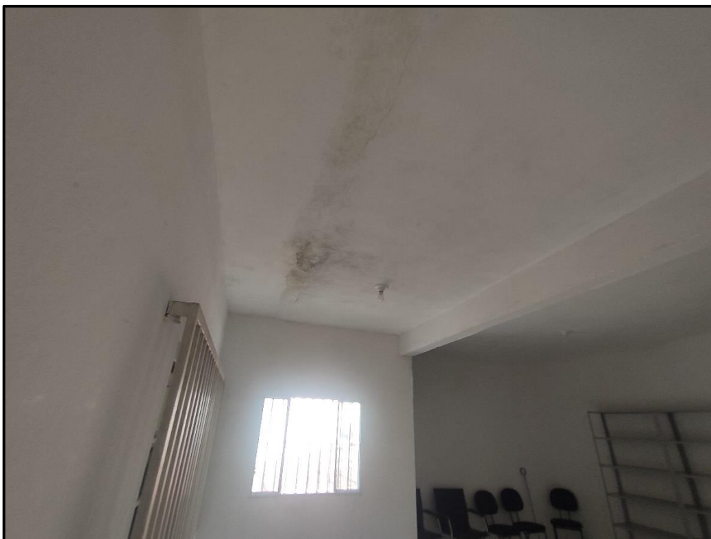
Ilustração 38: 1º pavimento (1º andar) – Estado de conservação do local copa
