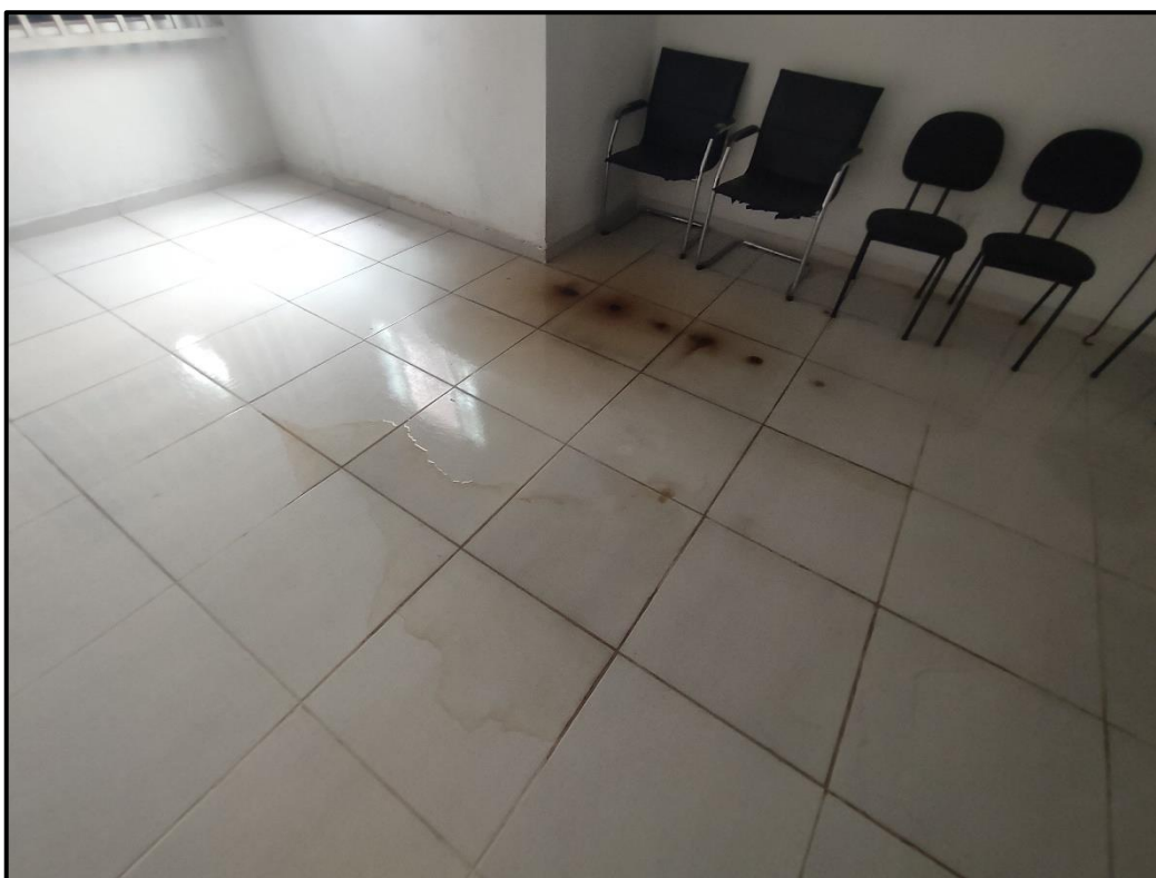
Ilustração 39: 1º pavimento (1º andar) – Estado de conservação do local copa
