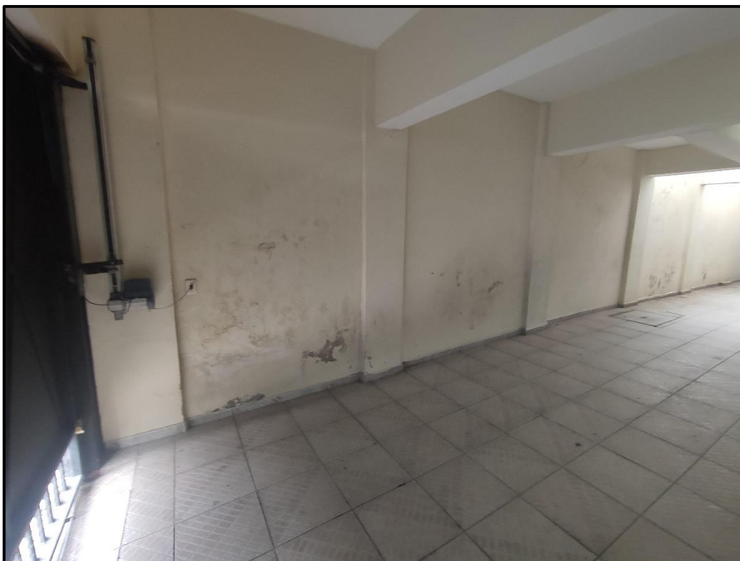
Ilustração 23: Pavimento térreo – Estado de conservação da garagem de veículos
